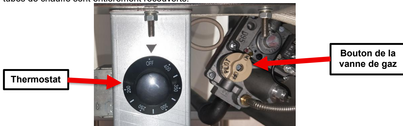
Figure B – Thermostat et vanne de gaz
