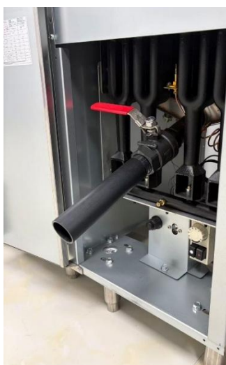
Figure D – Rallonge de vidange installée sur la vanne de vidange
